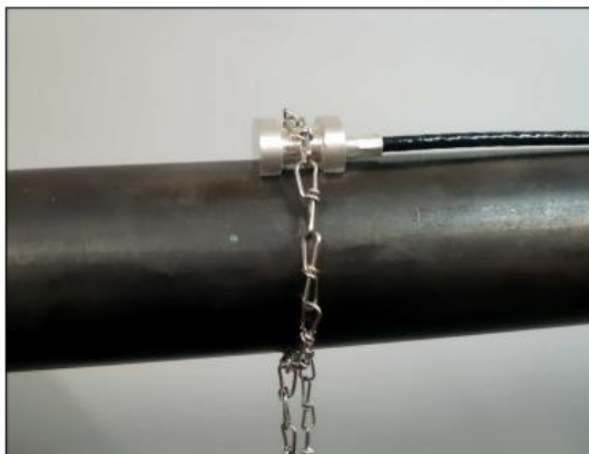
Датчик РТ100, прикрепленный к трубе
